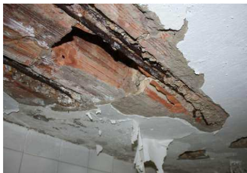
Estado de las armaduras en zona con mayor afección.
