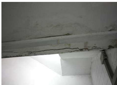
Estado del nervio de borde en hueco de escalera previo a la apertura de la cata
