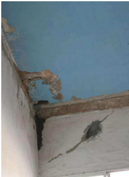
Grieta inclinada en fachada sur sobre carpintería.
