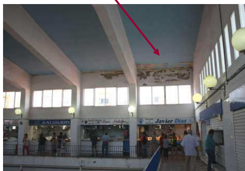
Filtraciones en esquina suroeste
