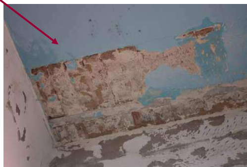
Filtraciones en esquina sureste
