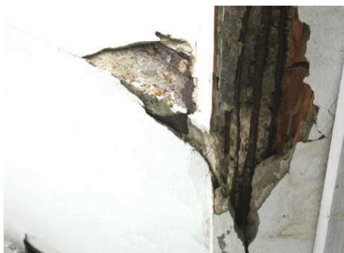
Armaduras con corrosión y pérdida de sección severa. Corrosión superficial de perfil de zanca
