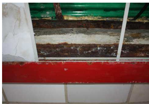
Ala superior de viga corroída
