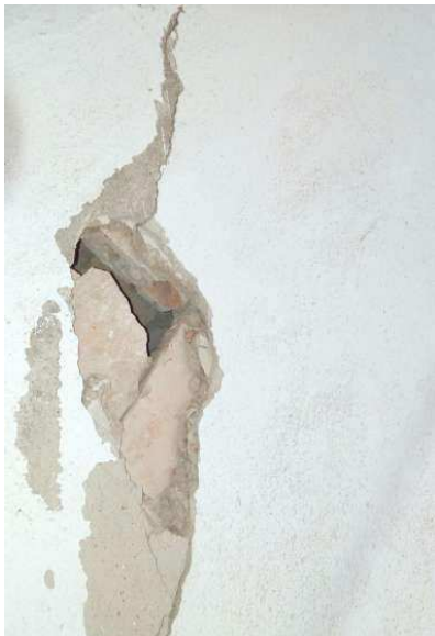
Detalle del daño donde se observa que afecta a la hoja interior del cerramiento.
