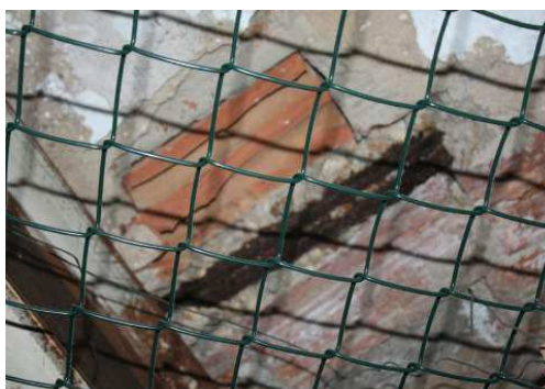
Nervio con la armadura corroída vista
