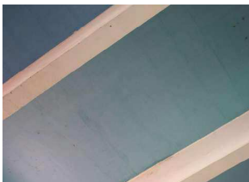
Fisuración marcando calles de bovedillas
