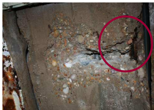
Viga: Ø25 con corrosión. Recubrimientos hormigón: lateral: 4 cm; inferior: 8 cm
