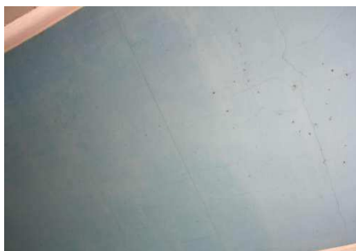
Fisuración marcando calles de bovedillas
