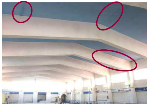
Filtraciones puntuales (vista desde fachada este)
