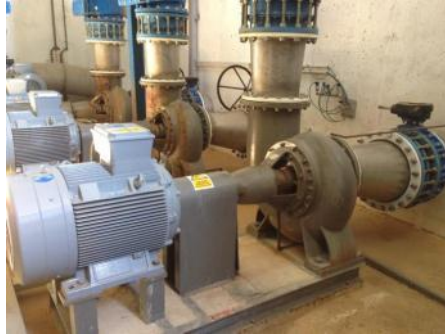
Detalle bombeo intermedio ETAP.
