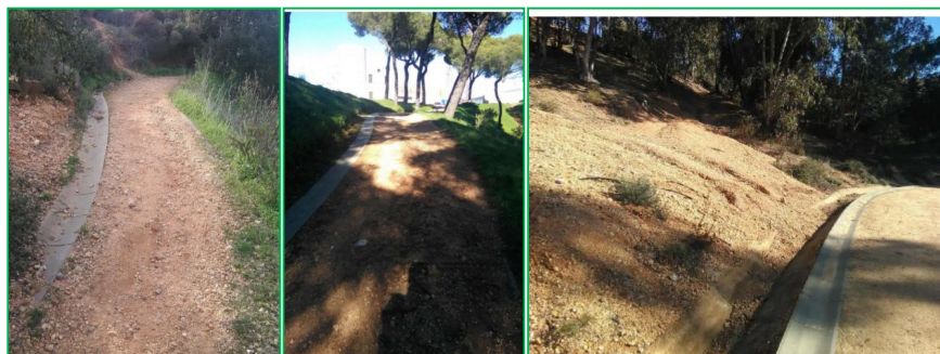
Tramos de caminos de zahorra deteriorados y aterramiento de cuneta de hormigón
