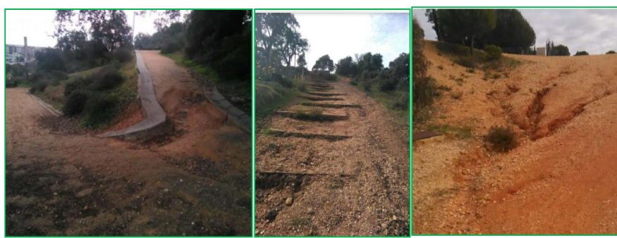
Importante afcción de caminos y taludes por erosión de escorrentía
