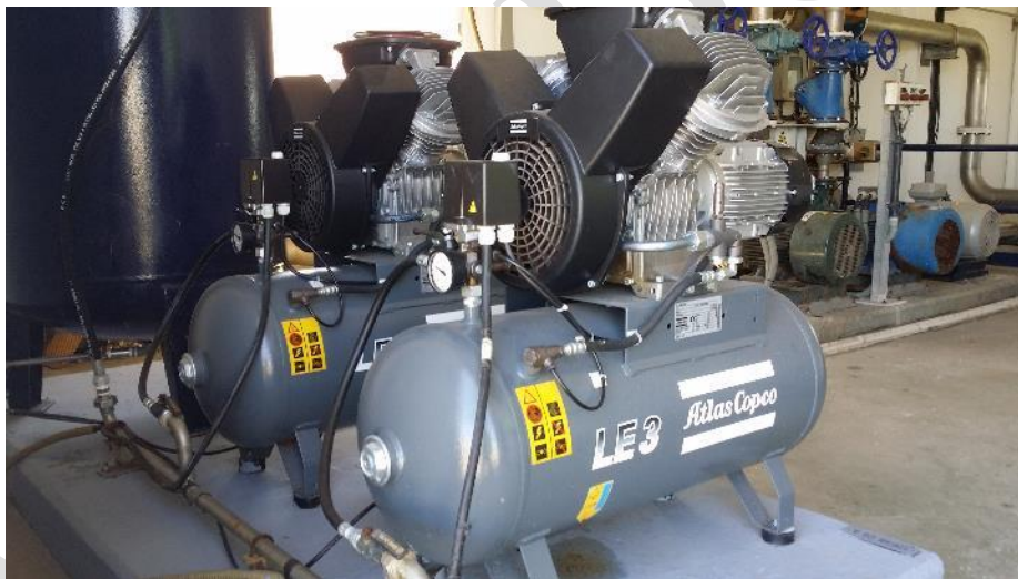
Compresores etapa Presurización de fangos biológicos.
