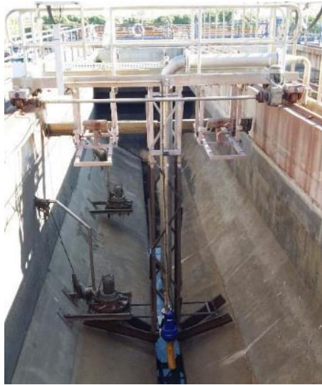
Estructura y bomba de desarenado.
