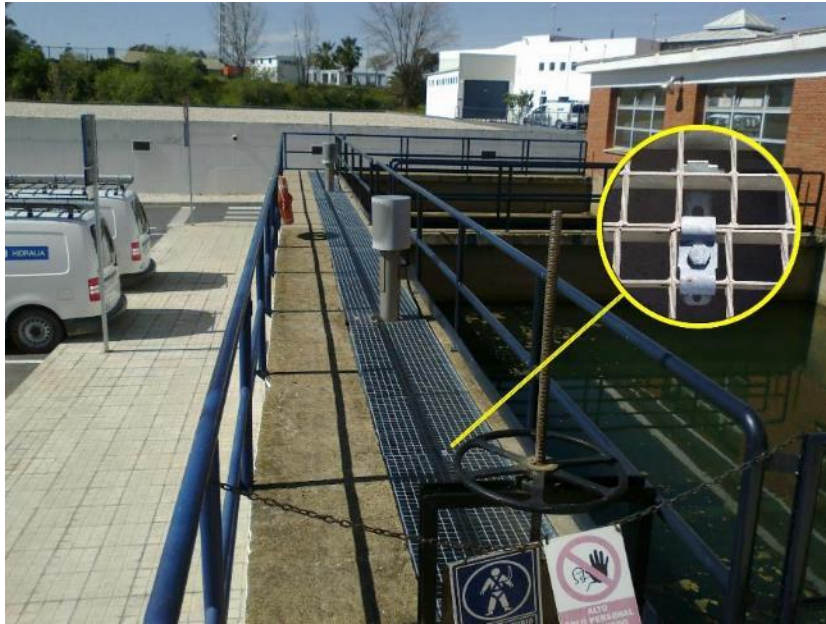
Detalle Filtros Dobles en ETAP
