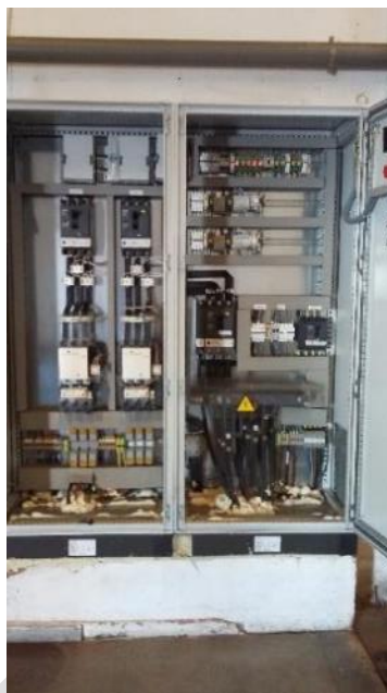
Cuadro de control Estación de Bombeo nº 3 bis
