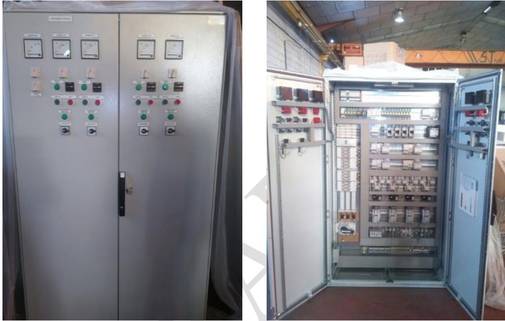
Cuadro de control y maniobras Estación de Bombeo nº6
