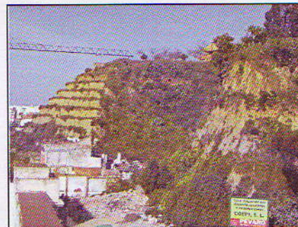
Foto. 14 – Detalle de escalonamiento vertical.
