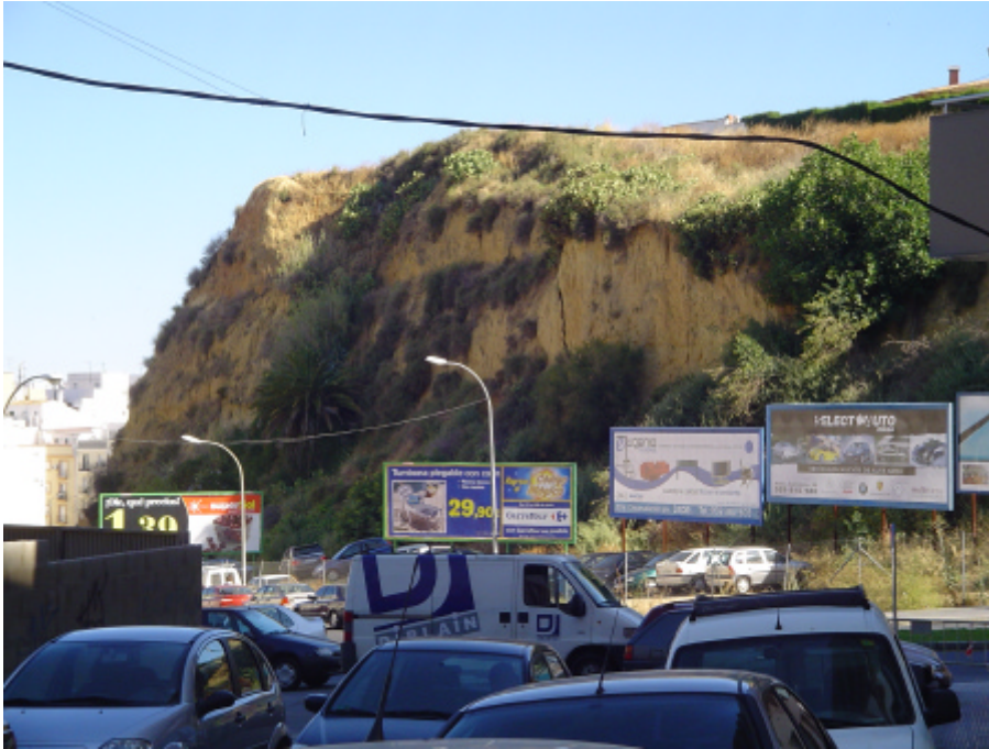
Foto 1. Cabezo Mondaca desde la calle Ramón Menéndez Pidal. Pueden observarse las litologías formadas por limos y arenas. El talud aquí presenta una altura considerable y está muy verticalizado, próximo al límite de su estabilidad como muestran la fracturas abiertas en algunos puntos.
