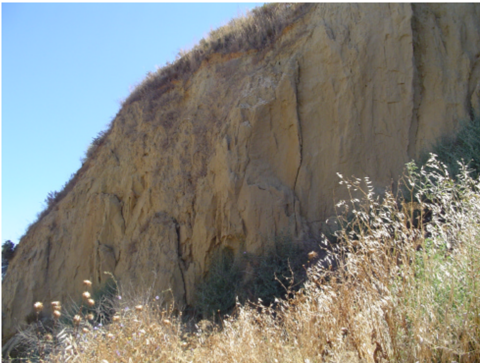
Foto 20. Foto de detalle del talud comentado en la foto F19. Pueden observarse las discontinuidades subverticales, esto unido a que el talud se encuentra subvertical provoca un importante riesgo de desprendimiento, sin embargo, en este punto tanto los vehículos como el paso de transeúntes quedan suficientemente alejados del talud.
