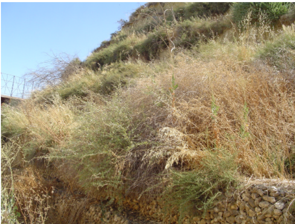
Foto 18. Muro de gaviones deformado y comentado en la foto F16.
