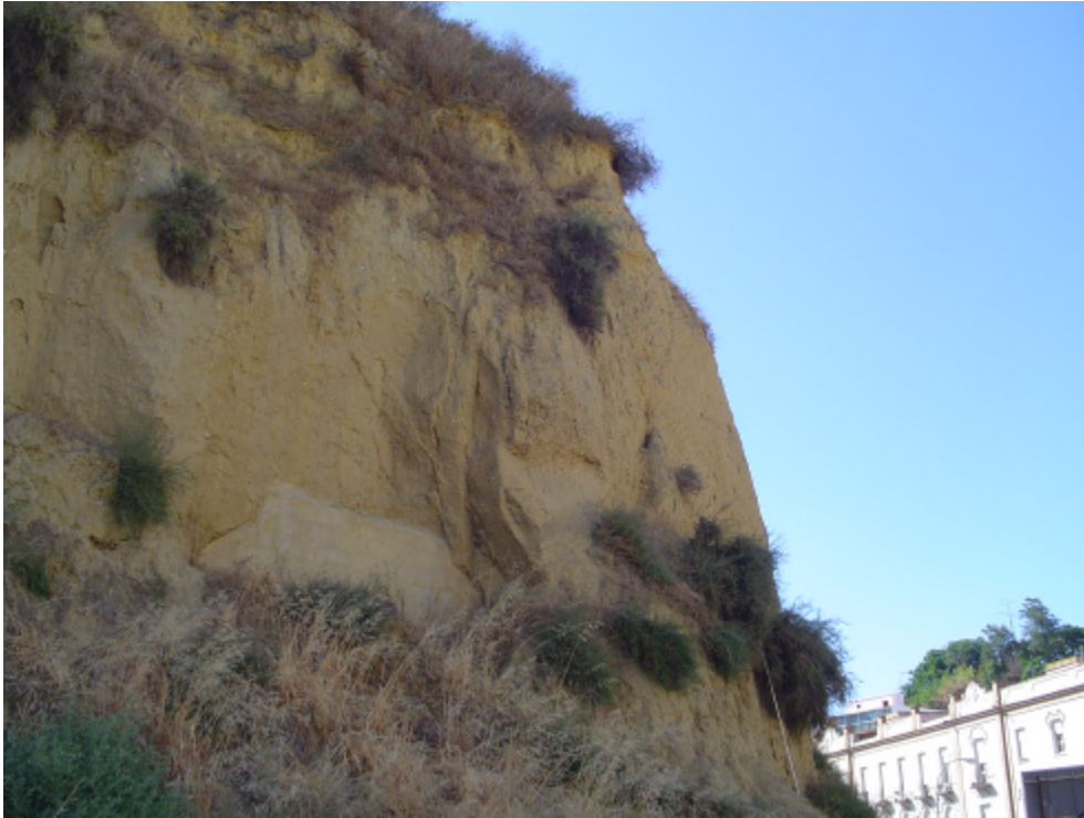
Foto 11. Otro punto de vista del talud comentado en la foto F9. Se pueden observar las fracturas subverticales que se relacionan con la inestabilidad de los taludes. Se haría necesario en este punto una estabilización mediante retaluzado (considerando medidas ambientales para evitar erosiones), una estabilización mediante elementos resistentes (muros, anclajes, etc) o cualquier otra medida que minimizara el riesgo de inestabilidad que se observa. Además sería conveniente colocar una valla de seguridad para evitar el aparcamiento de vehículos y tránsito de personas en las proximidades del talud.
