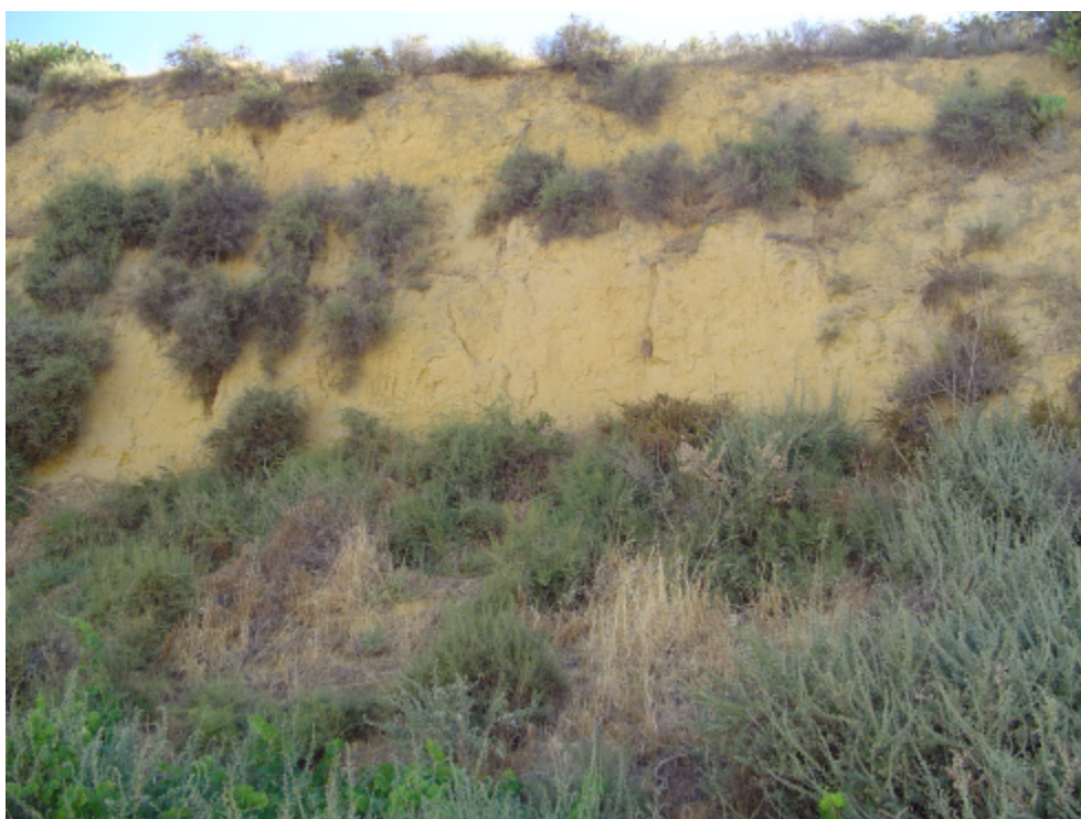
Foto 6. Foto más detallada del talud comentado en la foto F4.
