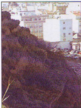
Fotos. 16 a 18 – Detalle de deslizamiento y deterioro de la escollera de base.
