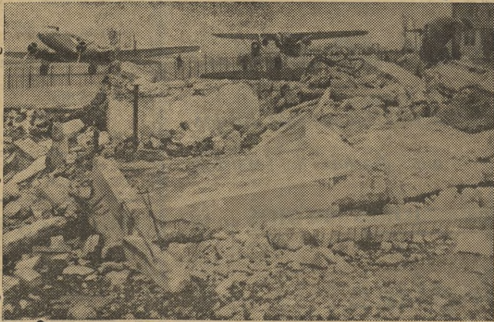
En Le Bourget (Francia) han empezado los trabajos para la construcción de un nuevo aeródromo que será el más moderno de Europa.
